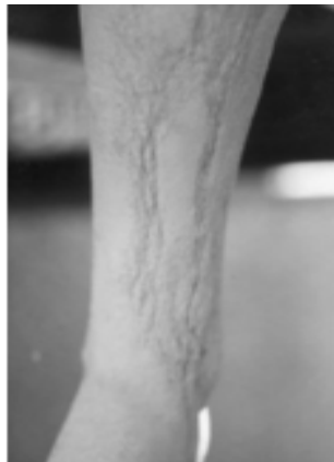
Fig. 21: Aproximación a patrones de escurrimiento con pérdida de material. La imagen es previa a la recuperación, a través de morteros, del perfil.
