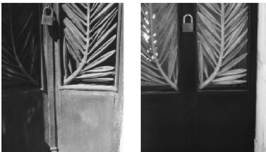
Fig. 9 Comparativa antes y después del tratamiento de puertas de hierro altamente corroídas. Puertas ingreso Monumento a E. Soler.
