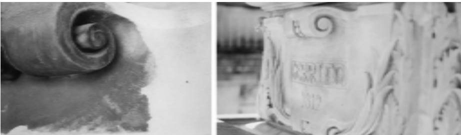
Fig. 28. Apróx. de costra negra de fuerte adherencia y imagen posterior a su eliminación. recuperando la lectura de la cartela y el fino tratamiento ornamental.
